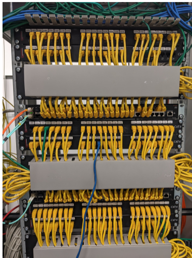
Obrázek: Rack s patch panely, kabelovými lištami a switchy
