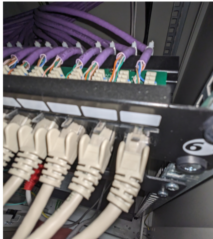
Obrázek: Zapojený patch panel Solarix
